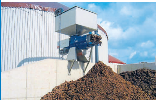
Biogasanlagen: Separation von Gärresten
